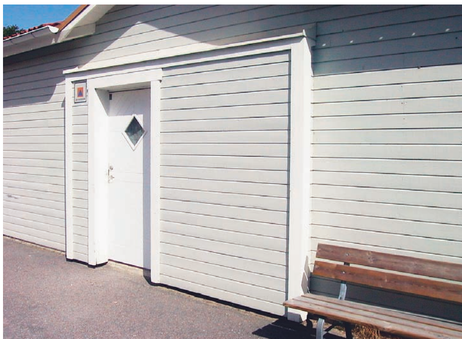
Bild 2. Här är skyddsrumsdörren uppställd och inbyggd. En fredsörr är i stället insatt i dörröppningen. Utförandet är gjort på ett sådant sätt att varken tillsyn eller kontroll är möjlig, varför kontrollanten kommer att kräva rivning av detta fasadparti.
