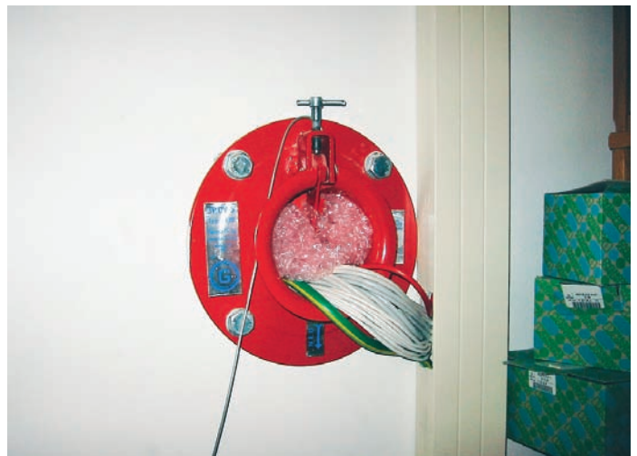
Bild 4. Övertrycksventiler är en klart olämplig väg att dra fredskablar genom skyddsrumsväggen. Kontrollanten kommer att kräva borttagning av dessa. Det finns godtagna lösningar för genomföring av kablar och rör för eftermontage.
