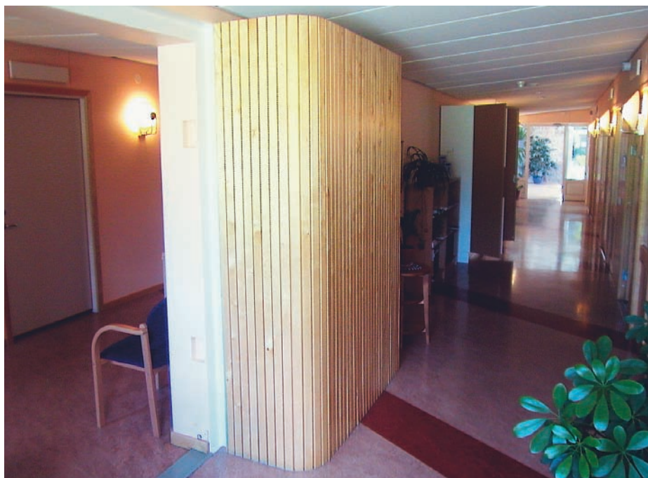
Bild 1. Skyddsrumsdörren är permanent kringbyggd och oåtkomlig för tillsyn och kontroll utan förstörande ingrepp. Kontrollanten kommer att kräva rivning av panelen.
